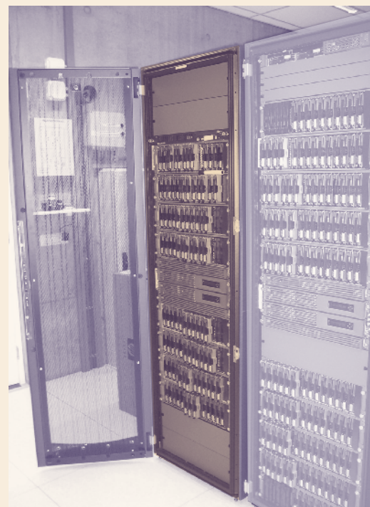
Rechts de SAN die de storing veroorzaakte, links de vervanger.
